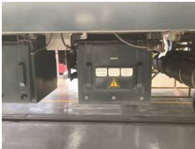
图 9.2-1 地铁列车蓄电池照片
